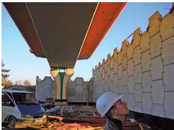
Najdłuższa w Polsce ściana oporowa z gruntu zbrojonego
