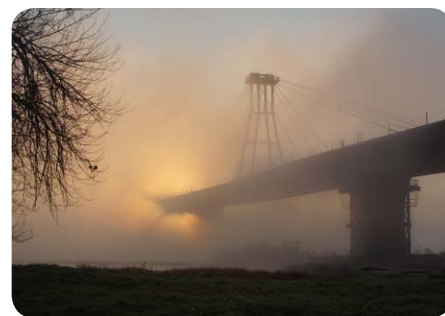
III nagroda – Marek Rzytelewski (Bydgoszcz) „Poranek w Solcu nad Wisłą” – budowa mostu przez Wisłę w m. Kamień
