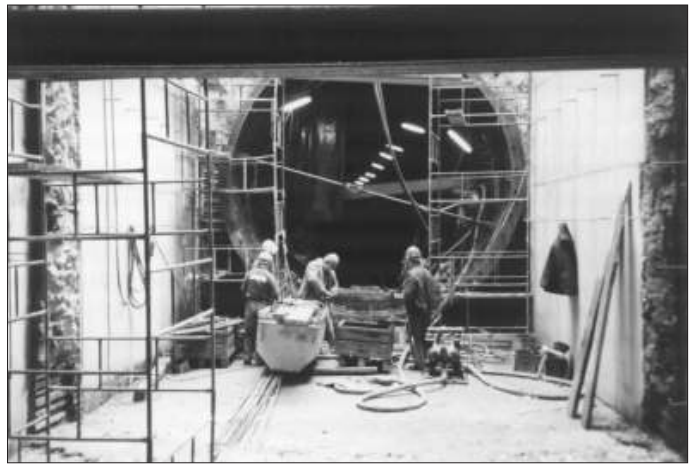
Podczas zwiedzania stacji mieliśmy niecodzienną okazję zajrzenia do tuneli, którymi już niedługo będą jeździły pociągi
