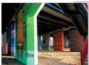
Estakada w ciągu ul. Kościuszki w Toruniu Andrzej Marecki – godło IL PONTE 04
