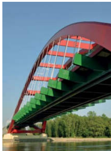
I nagroda – Mariusz Prędoła „Puławy – most im. Jana Pawła II przez Wisłę”
