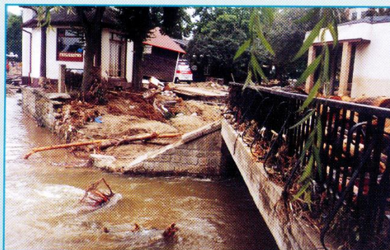
Widok zniszczonego nabrzeża i zniszczonego przez wodę dojazdu do mostu
