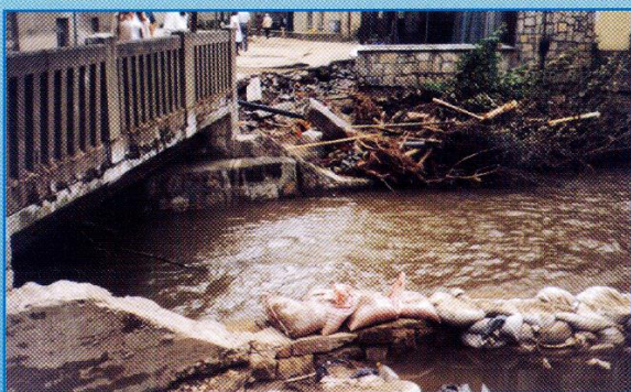
Widok zniszczeń dojazdów do mostu w centrum Dusznik
