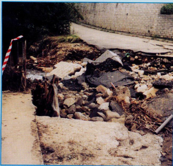
Widok zniszczonego dojazdu do mostu drogowego
