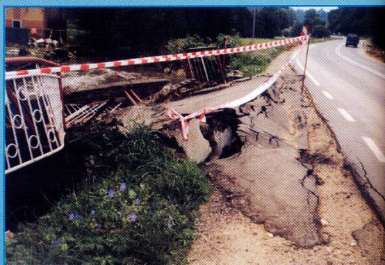
Widok zniszczonego mostu. Podmyta podpora, przesłono zatopione, zniszczenie dojazdu.
