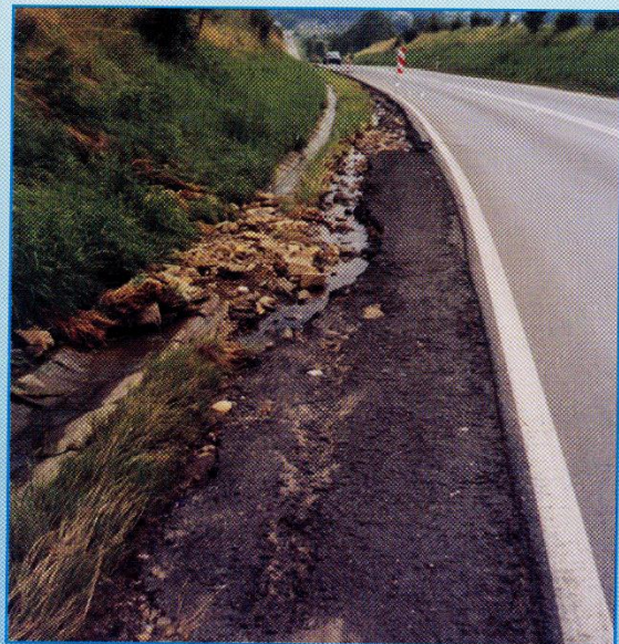
Widok zniszczenia pobocza przy trasie Kłodzko-Kudowa, rozmyta skarpa, widoczne ograniczenie pasa ruchu.
