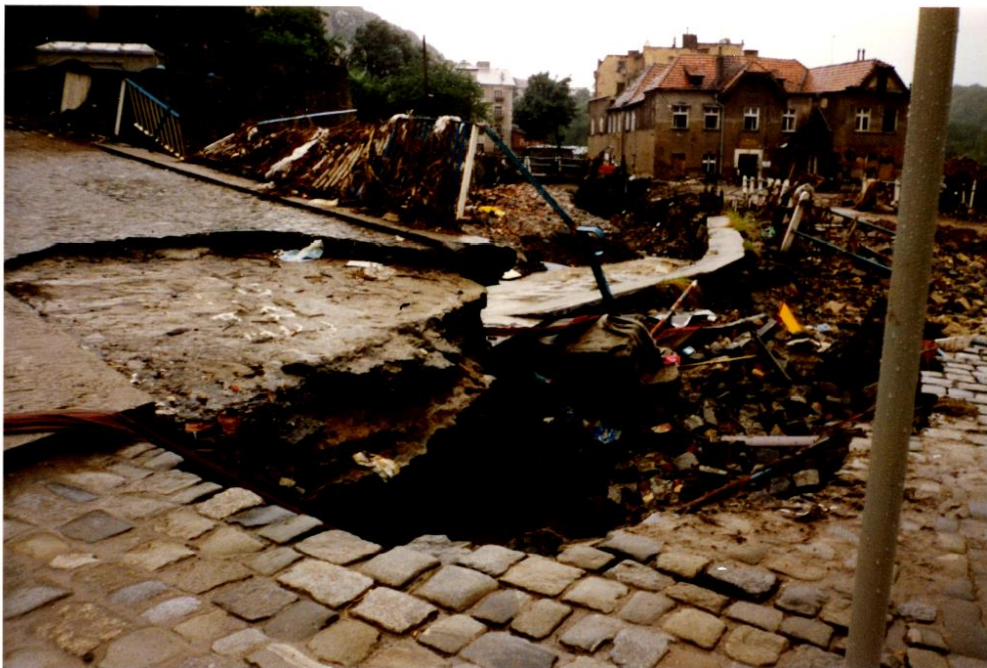
Fot. 16. Wyrwy w strefie nadbrzeżnej ulic i przyczółków mostu w Kłodzku, 18-19.07.1997 r.
