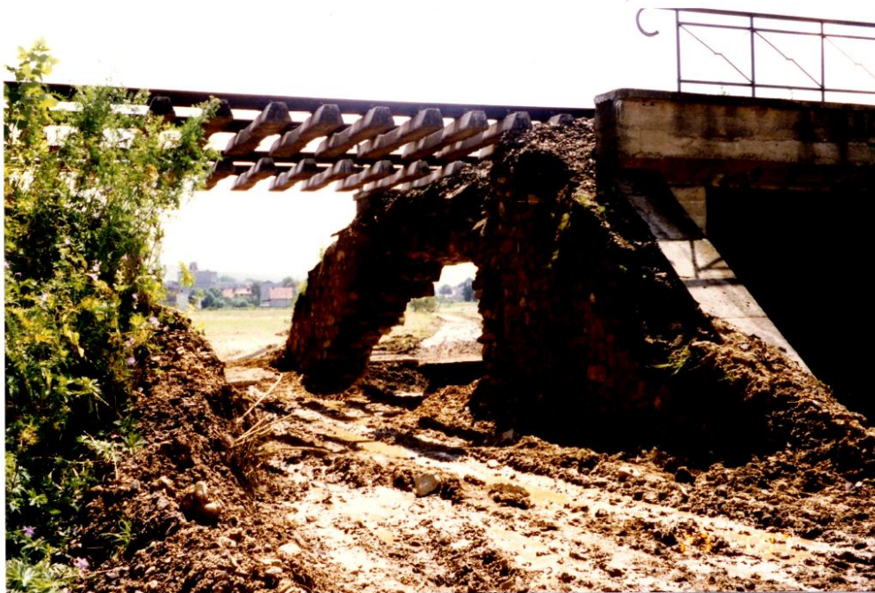
Fot. 10. Widok rozmytego nasypu za przyczółkiem wiaduktu kolejowego nad drogą polną na trasie Kłodzko - Międzygórze linii Wrocław - Międzylesie, 27.07.1997 r.
