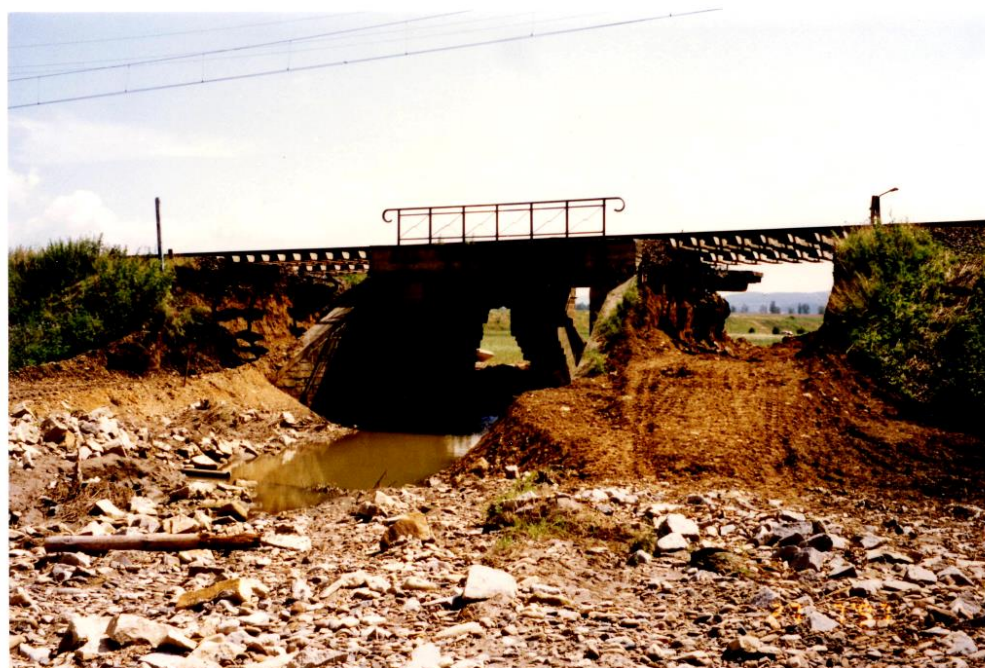
Fot. 11. Widok rozmytego nasypu za przyczółkiem wiaduktu kolejowego nad drogą polną na trasie Kłodzko - Międzygórze linii Wrocław - Międzylesie 27.07.1997 r.
