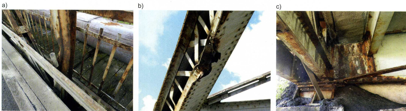
Rys. 8. Przykłady uszkodzeń i degradacji elementów konstrukcji mostu sprzed rewitalizacji [7]: a) uszkodzony i zdeformowany słupek kratownicy, b) uszkodzony i zdeformowany element stężenia poprzecznego dźwigarów kratowych, c) widok od spodu skorodowanych elementów konstrukcji stalowej
